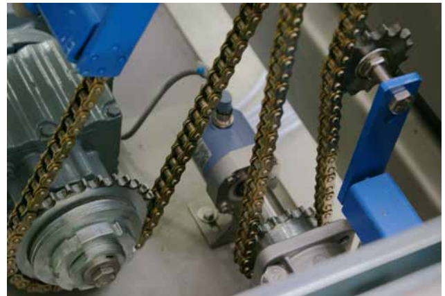
Abbildung 6 Die exakte Position der Kartontage ermitteln Drehgeber von Wachendorff. Ihre Impulse dienen der Steuerung als Information, wann der nächste Teilschritt des Prozesses ausgelöst werden kann.
