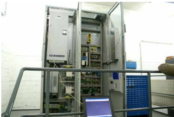
Abbildung 6 Steuerung: Hier der neue Schaltschrank mit GSV und Liftsteuerung.
